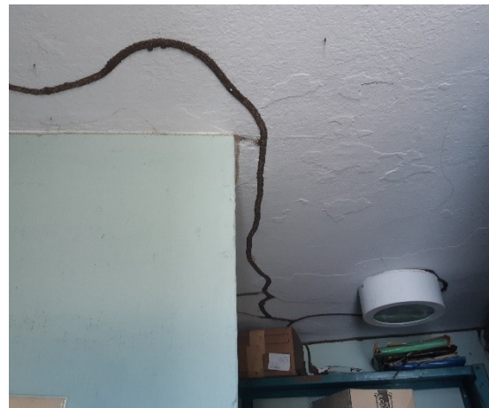
Figura 22- Ataque de térmitas no segundo pavimento
