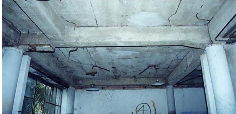
Figura 08- Forro retirado mostrando ataque de xilófagos na edificação antes da reforma.
