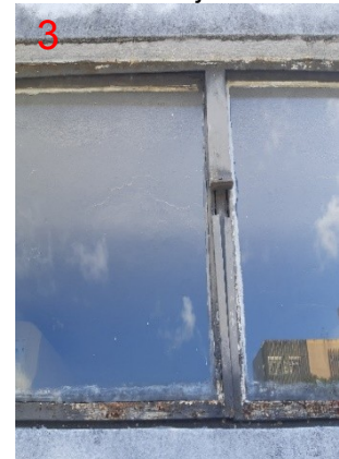
Figura 14 – Esquadrias deterioradas- janela.
