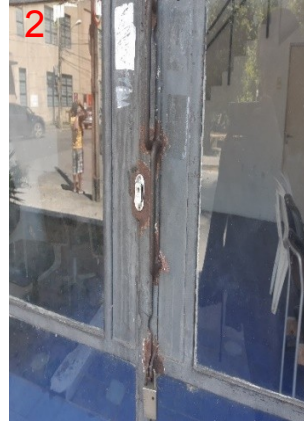
Figura 13 – Esquadrias deterioradas -porta.
