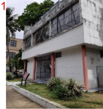
Figura 12 – Depósitos escuros nas fachadas
